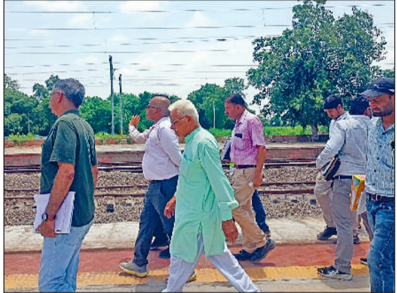
मंडी अटेली। मुख्य प्रशासक अटेली में दोहरीकरण के कार्य का निरीक्षण करते हुए। फोटो: हरिभूमि
